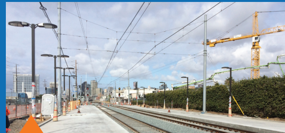
Cables que cruzan la calle. Esta disposición de cables se utilizará en secciones de la alineación donde el tranvía viajará en ambas direcciones.
